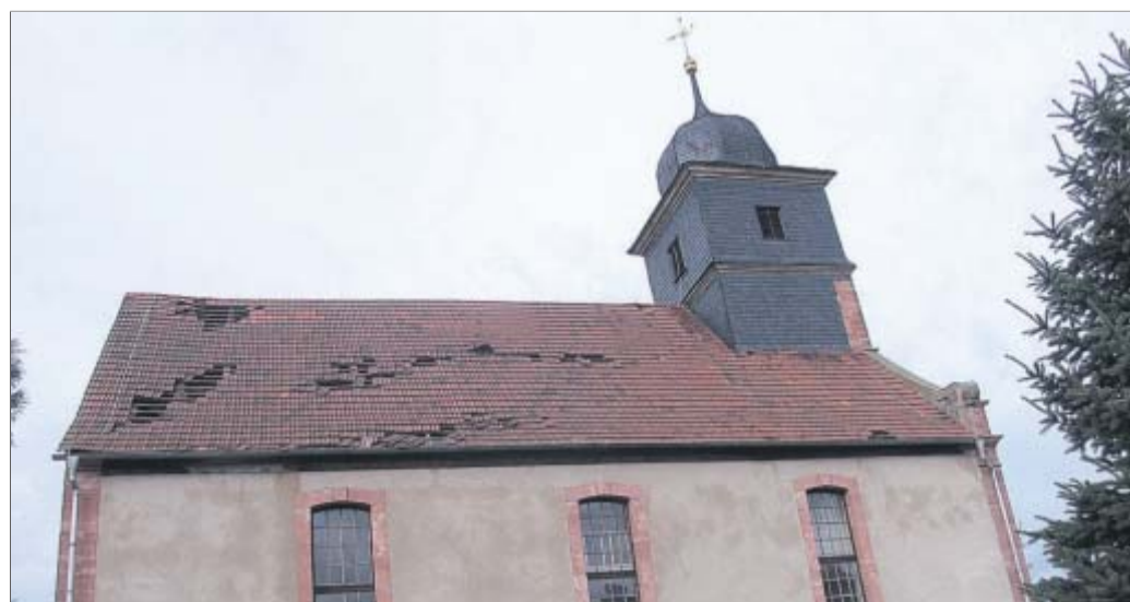
Viele Dächer in Diedorf beschädigte der Wirbelsturm, darunter auch das der Kirche. Provisorisch wurden am Montag die Löcher wieder verschlossen. FOTO: NELITZ
